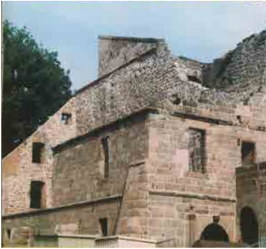
Château du Lichtenberg avant travaux © Château du Lichtenberg
